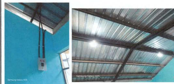
Foto 3: Se observa la instalación de energía eléctrica en aula No.3, y bodega.
