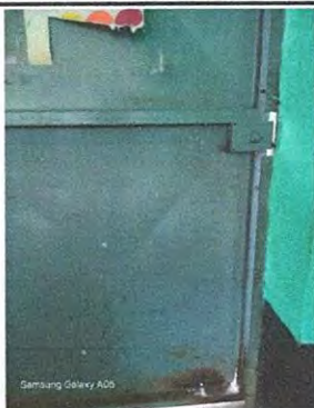
Foto 3: Se observa el deterioro de la puerta del aula No. 1, se reparará, pintará y se sustituirá chapa.
