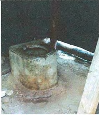
Foto 1: Se observa el derioro de la letrina y no hay sanitarios para hombres, ni mujeres.
