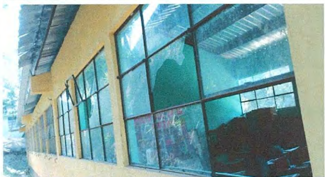
Foto 1: Se observa el deterioro de los vidrios de algunas ventanas en la parte de atrás de las aulas, se colocará los vidrios que hacen falta y 12 balcones.
