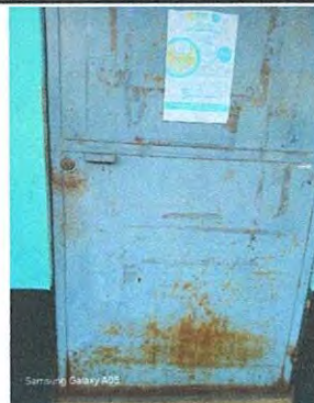
Foto 4: Se observa el deterioro de la puerta del aula No. 2, se reparará y se pintará.
