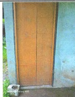
Foto 4: Se observa puerta de madera en bodega, se sustituirá por puerta de metal con pasador.
