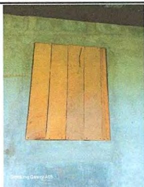
Foto 3: Se observa ventana de madera en bodega, se sustituirá por ventana de metal con vidrios, por seguridad.
