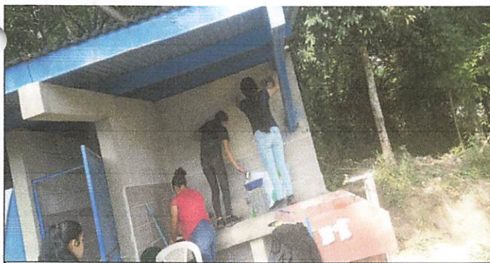
Foto 5: Pintado de pared de sanitarios
