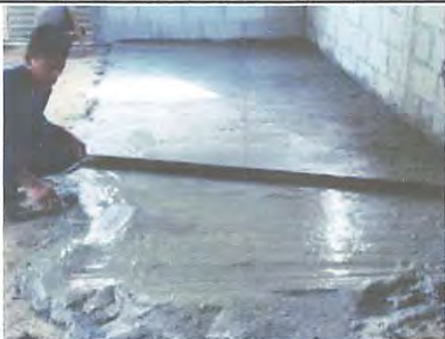
Foto 19: Torta de cemento.
