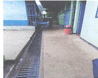
Foto 2: Cuneta para tres pilas con regilla
