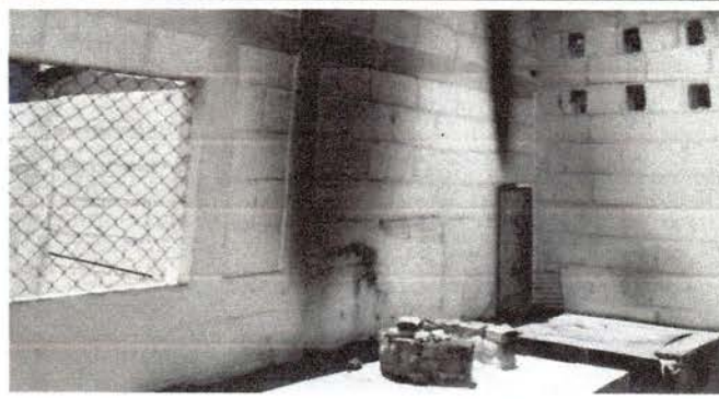
Foto 4: Pared y techo deteriorado
