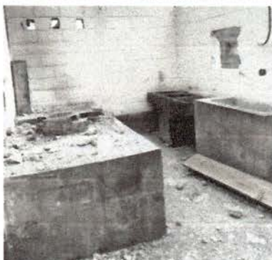
Foto 3: Pollo de cocina deteriorado
