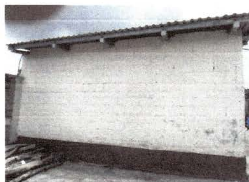
Foto 2: Pared de cocina deteriorada
