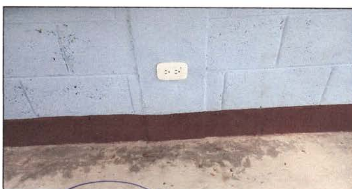
Foto 6: Tomacorrientes instalados finalizado.
