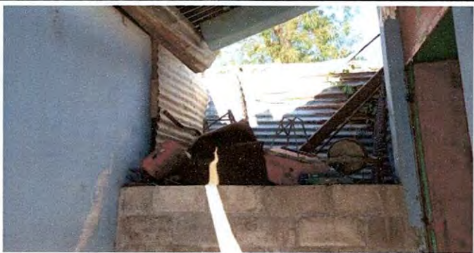
Foto 15: Se necesita finalizar el muro para evitar la entrada de tierra y lodo en las instalaciones.
