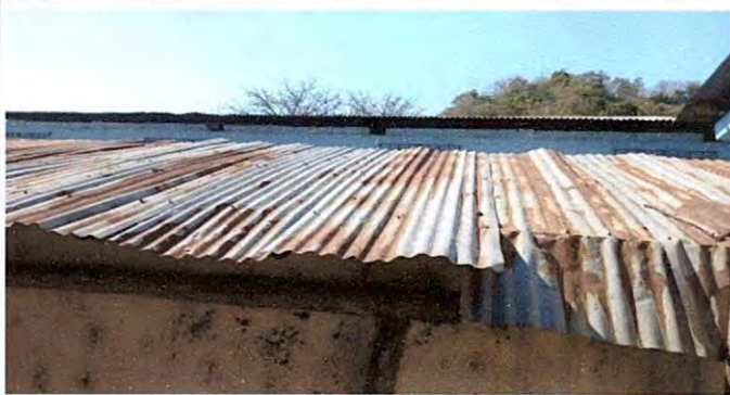
Foto 13: Debido al mal estado del techado en sanitarios, se necesita la instalación de lámina troquelada.
