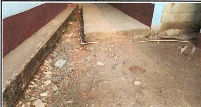
Foto 19: se necesita cubrir con torta de cemento en patio de salón y sanitarios.
