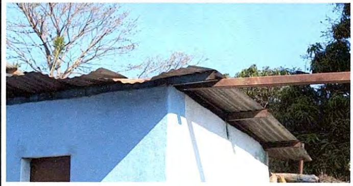
Foto 14: La estructura portante de metal se encuentra desajustada y en mal estado, por ello se necesita el cambio e instalación de la misma.
