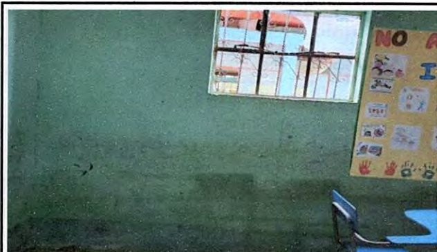
Foto 21: se necesita pintar los muros en salones.
