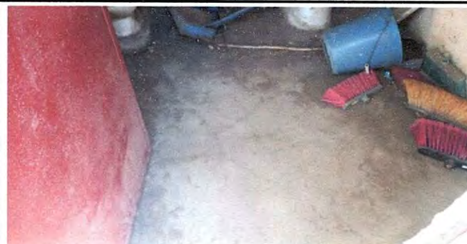
Foto 12: Debido al deterioro de tortas de cemento en sanitarios, se necesita la colocación e instalación de piso antideslizante.
