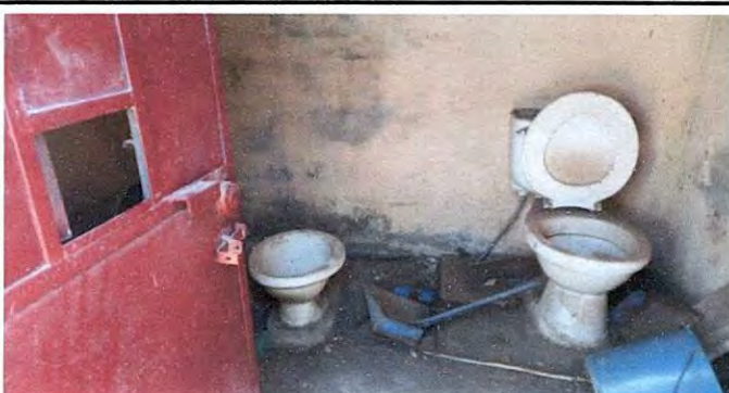
Foto 9: Se necesita la Fundición de módulo de migitorio, tipo pileta, debido a la cantidad de niños existentes en la escuela.
