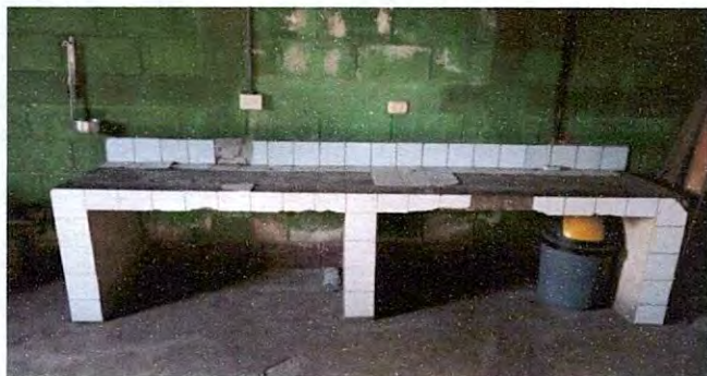
Foto 1: Mantenimiento de mueble de cocina por deterioro.
