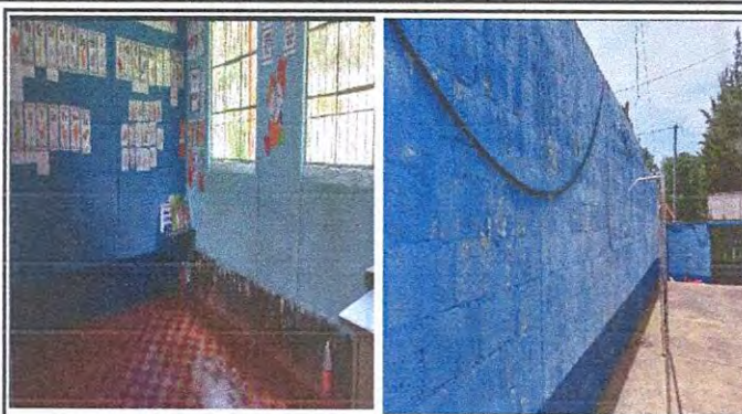
Foto 2: Pintura en pared para toda la escuela.
