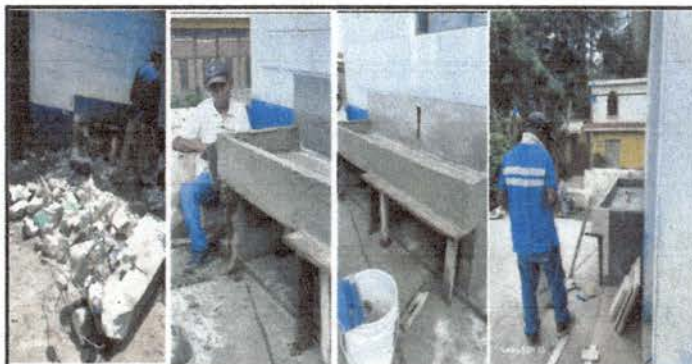
Foto 6: filtracion de agua en cocina, por lavamanos
