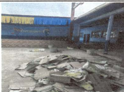
Foto 3: piso en corredor
