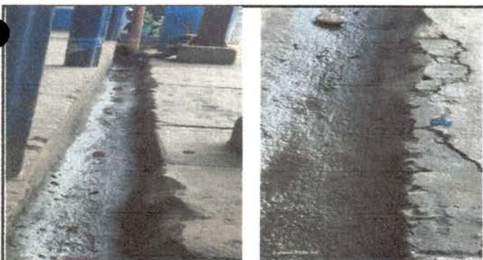
Foto 5: parrilla en sanja de bajadas de agua
