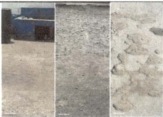
Foto 3: piso en corredor
