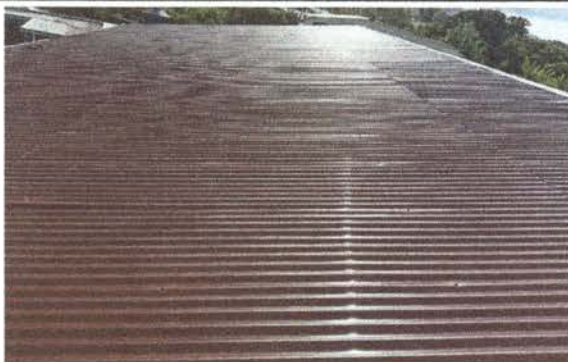
Foto 3: Techo de dos alas completamente oxidadas,
