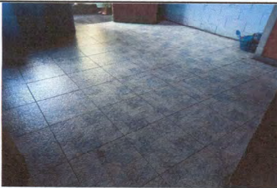
Foto 3: Piso en cocina
