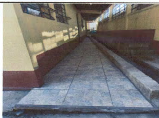
Foto 9: Piso pasillo 2 planta baja
