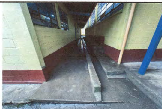
Foto 9: Piso pasillo 2 planta baja
