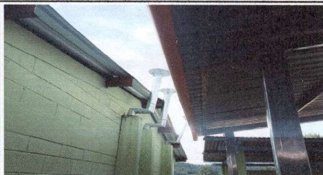
Foto 1: CHIMENEAS - PINTURA - CAIDAS DE AGUA
