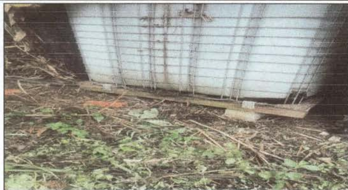
Foto 1: Tinaco engrietado, en total deterioro
