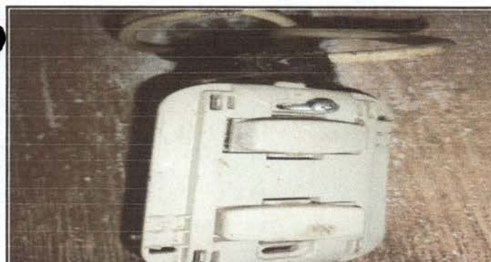
Foto 5: Así estaba deteriorado el interruptor anteriormente.
