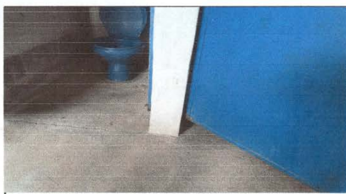
Foto 4: Sustrucción de piso torta por azulejo alrededor de las tazas de los servicios sanitarios.
