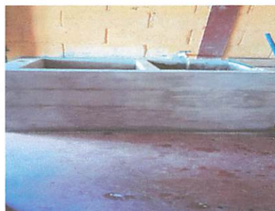
Pila pequeña y lavadero en cocina terminada y funcionando.
