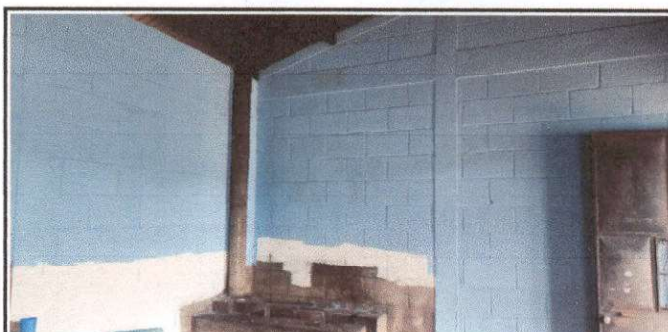
Foto 5: Pintura en cocina
