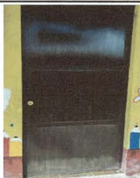
Foto 11: Puertas con chapas nuevas y en mejores condiciones
