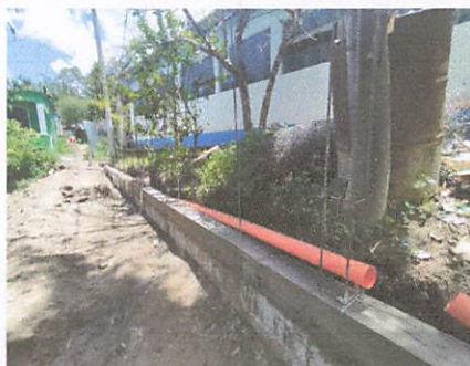
Foto 1: La tubería se redirige hacia la cuneta de la calle.
