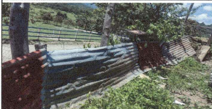
Foto 2: Falta construcción de muro con block
