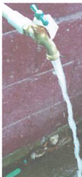
sistema de agua potable funcionando al 100%
