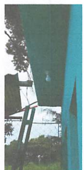
energia electrica en area de sanitarios y pila
