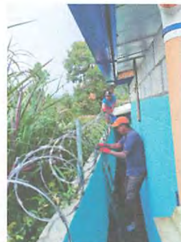
seguridad perimetral en la parte trasera de la escuela
