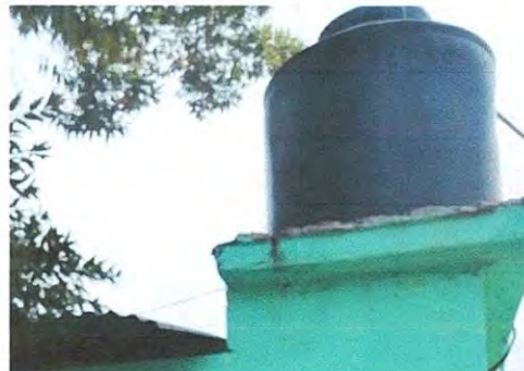
tinaco en mal estado
