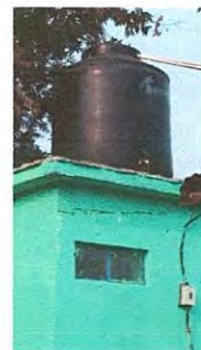
sistema electrico para bomba al tinaco
