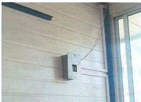
cambio de caja de flipones en modulo
