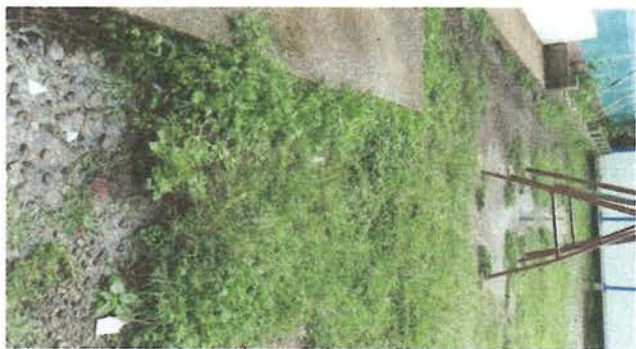
Fotografía No. 9: Deterioro de torta de cemento del patio de juegos de la Escuela Oficial De Párvulos.
