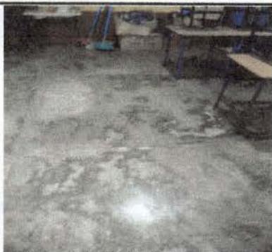
Foto 3: PISOS TORTA DE CONCRETO EN AULAS SIN PISO CERAMICA, ES NECESARIO INSTALAR PISO CERAMICA ANTIDESLIZANTE.
