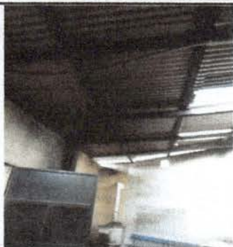
Foto 1: TECHO DETERIORADO, ES NECESARIO EL CAMBIO DE ESTRUCTURA PORTANTE POR ESTRUCTURA DE METAL.
