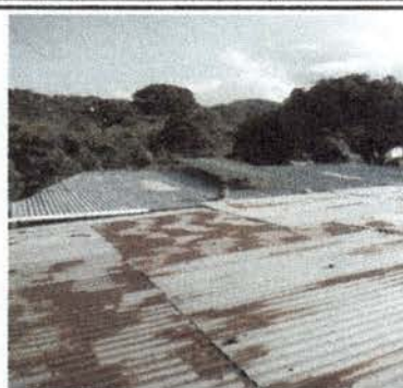
Foto 2: TECHO DE COCINA CUBIERTA DE LAMINA EN MAL ESTADO, ES NECESARIO SUSTITUIR LAMINA POR LAMINA TROQUELADA.
