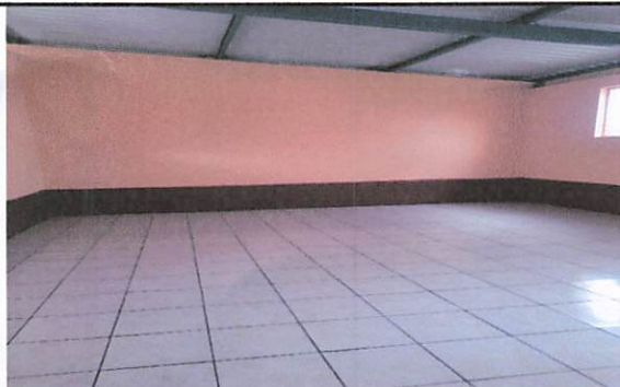
Foto1: piso y pintura
