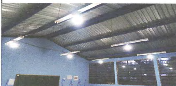
Foto 4: mejoramiento del alumbrado eléctrico de 4 salones de clases con 6 unidades eléctricas en cada salón de clases
