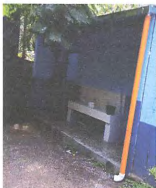
Foto 9: canal en techo de batería de sanitarios
