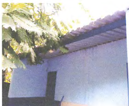
Foto 9: canal en techo de batería de sanitarios
