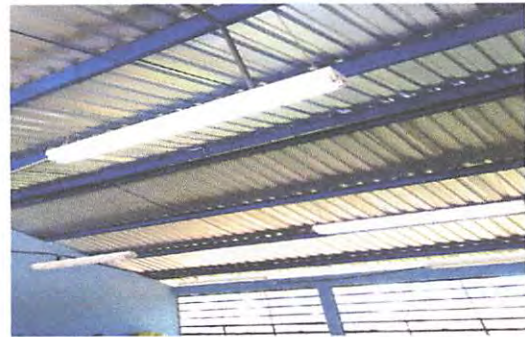
Foto 4: mejoramiento del alumbrado eléctrico de 4 salones de clases con 6 unidades eléctricas en cada salón de clases
