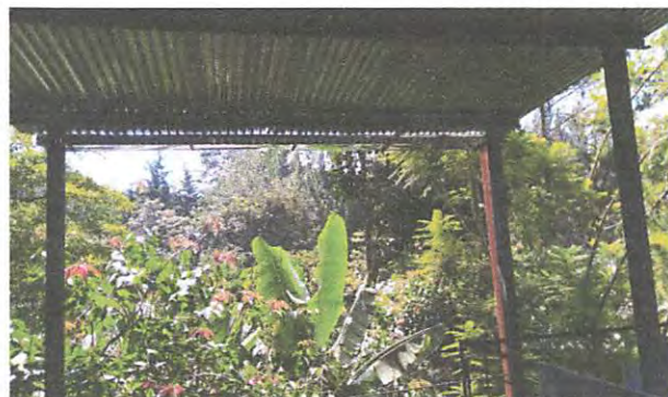
Foto 8: canal en techo del segundo nivel en bajada de gradas
