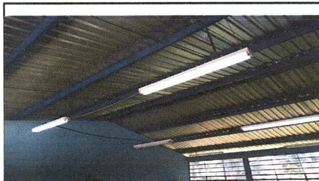
Foto 4: mejoramiento del alumbrado eléctrico de 4 salones de clases con 6 unidades eléctricas en cada salón de clases
