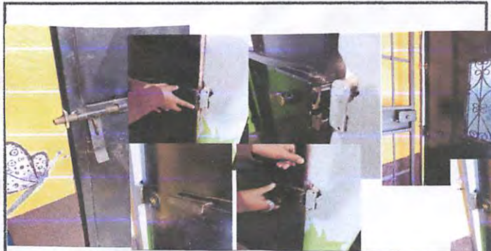
Foto 16: Chapa debido al mal estado de las puertas no se puede cerrar ni abrir
