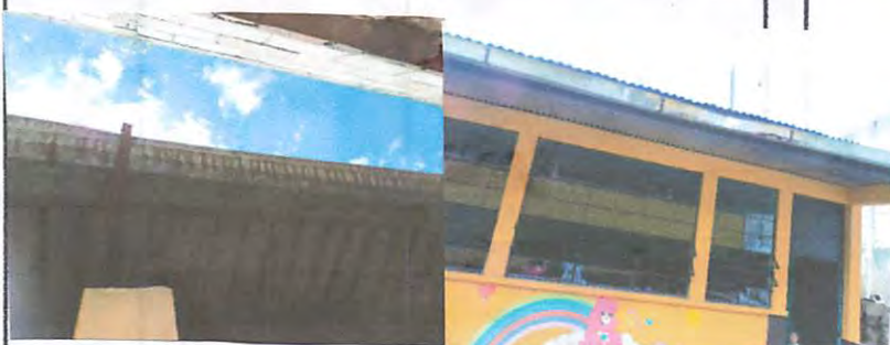
Foto 15: Canales: se encuentran ya picados por los años de uso.
