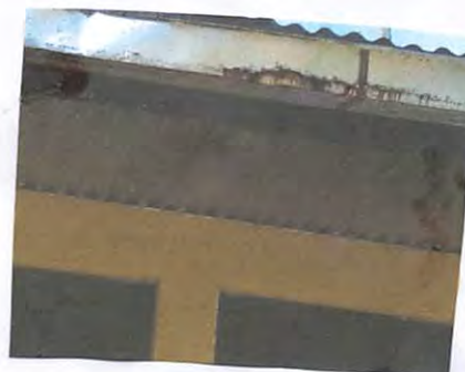
Foto 15: Canales en mal estado, picados.
