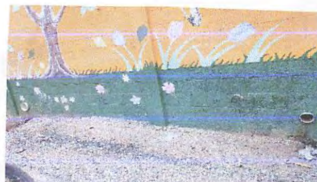
Foto 8: Banqueta. Debido a que por la lluvia la pared se esta humedeciendo y esto entorpece su deterioro.
