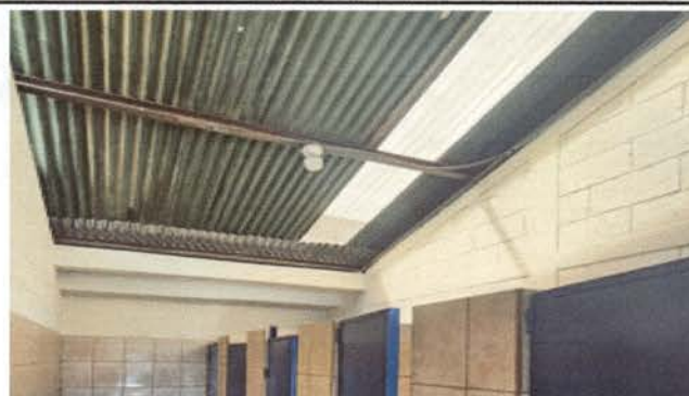
LA FOTOGRAFIA MUESTRA LA LAMINA DE ALUZINC QUE ILUMINA LOS SANITARIOS CON LUZ NATURAL
