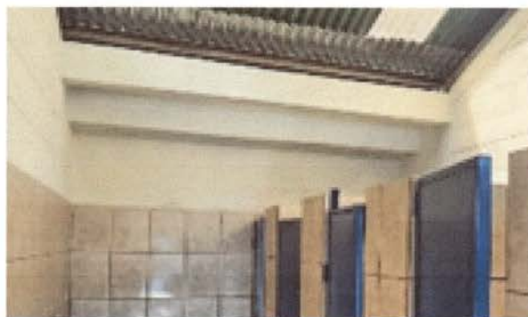
LA FOTOGRAFIA MUESTRA EL REPELLO Y CERNIDO QUE SE ENCUENTRA EN EL FONDO DE LOS SANITARIOS
