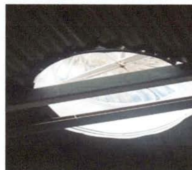
LA FOTOGRAFIA MUESTRA LA VENTAJA DE LA COLOCACIÓN DE LOS EXTRACTORES TANTO CON LA ILUMINACIÓN COMO DE LA VENTILACIÓN.
