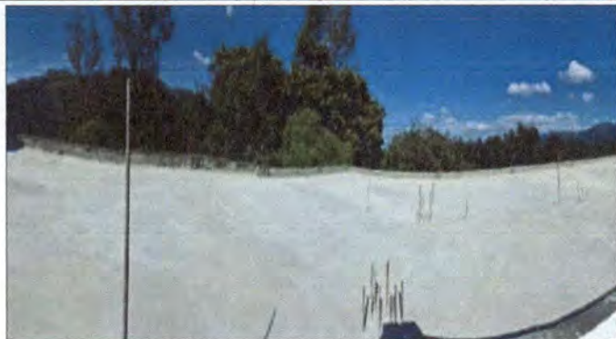
Foto 2: Impermiabilizar terraza segundo nivel.
