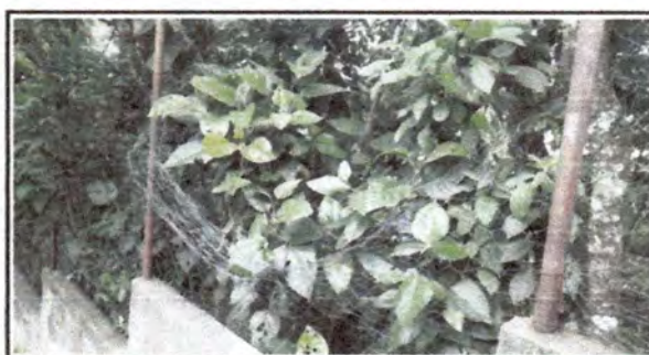
Foto 6: La malla del muro perimetral ya no es funcional por lo que cualquier persona entra facilmente al establecimiento.
