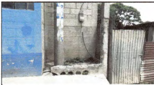
Foto 4: senecesita una baranda en este lugar ya que lo utilizan para orinar y defecar.
