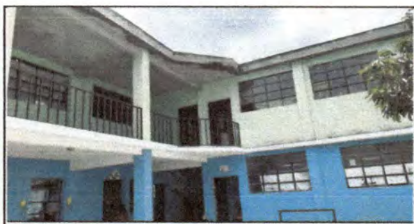
Foto 5: La pintura del segundo nivel se encuentra en mal estado
