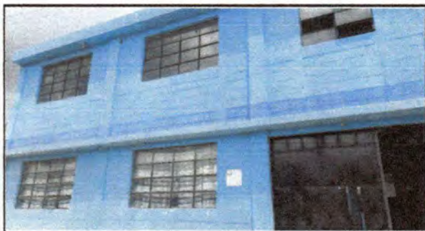
Foto 3: Las ventanas necesitan balcones ya que facilmente entran al establecimiento personas no deseadas.
