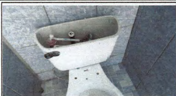
Foto 1: Servicios sanitarios con accesorios en mal estado por lo que no se puede suministrar agua de manera correcta.
