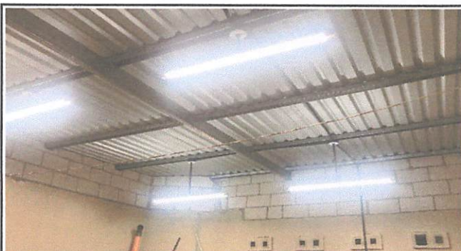
Foto 4: Iluminación bodega donde está la bomba de agua
