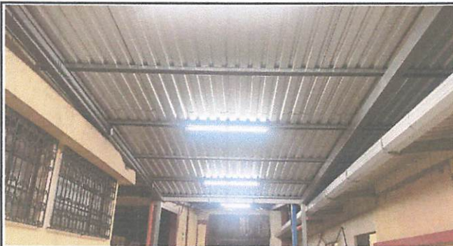
Foto 1: Tejado e iluminación del corredor frente a la bodega donde está la bomba de agua
