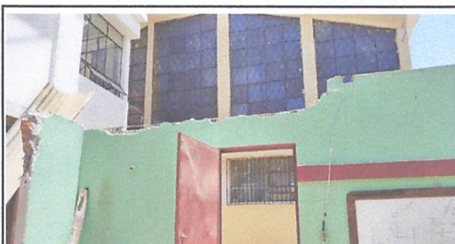
Foto 6: Destechado de Salón de Educación Física
