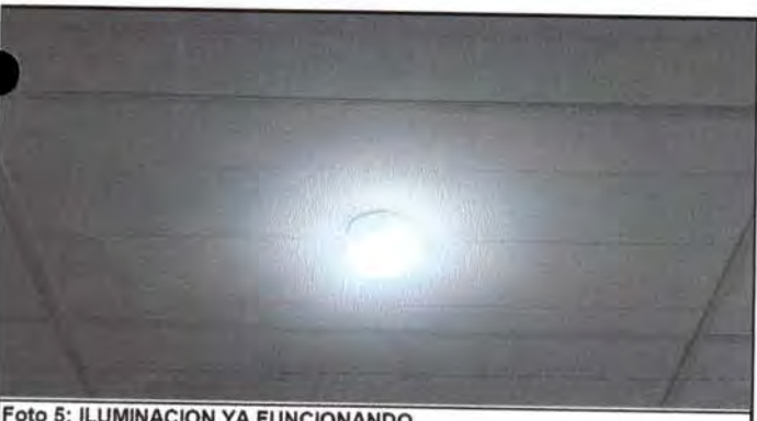
Foto 5: ILUMINACION YA FUNCIONANDO
