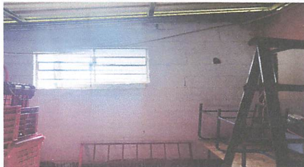
Foto 2: Falta de balcones para resguardo en cocina.
